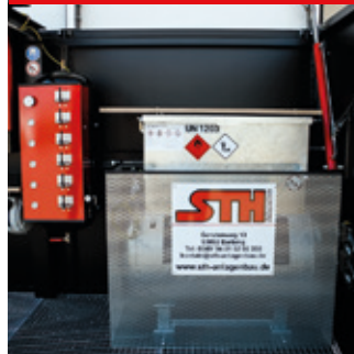
Benzintank KC500/ Bedieneinheit der Pumpen
